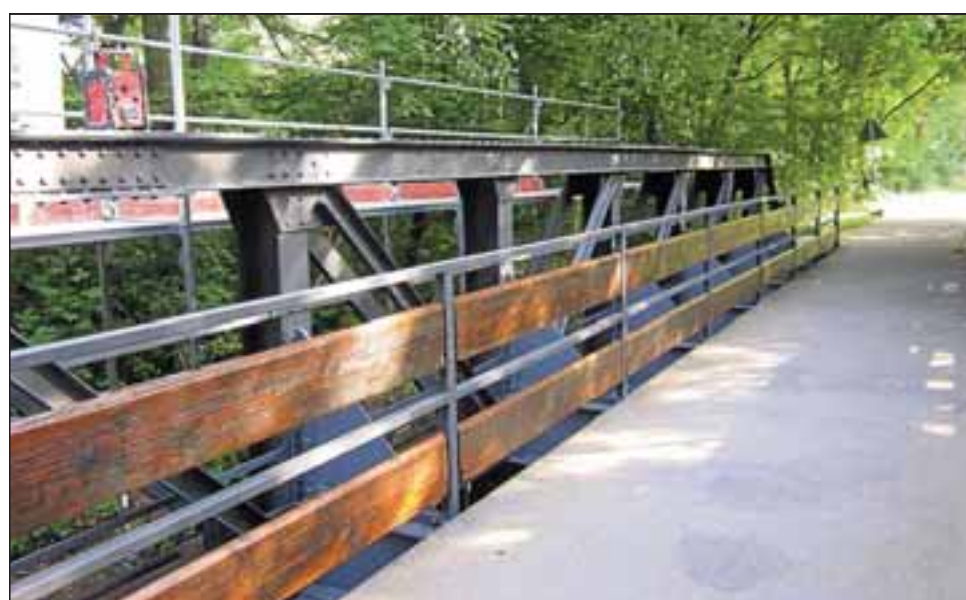
Die alte Eisenbahnbrücke am Radweg nach Dieheim (in Höhe Altwieslochs) ist eine der Brücken, die von der Stadt ausgebessert und saniert wurden. Foto: Stadt Wiesloch
